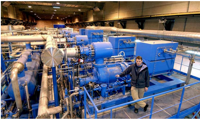
Estación de compresión de helio del LHC en el CERN.
